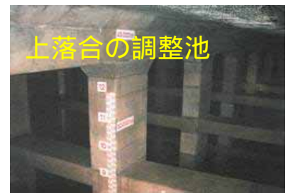
下水道施設に入ってきた雨を溜める下水道施設
